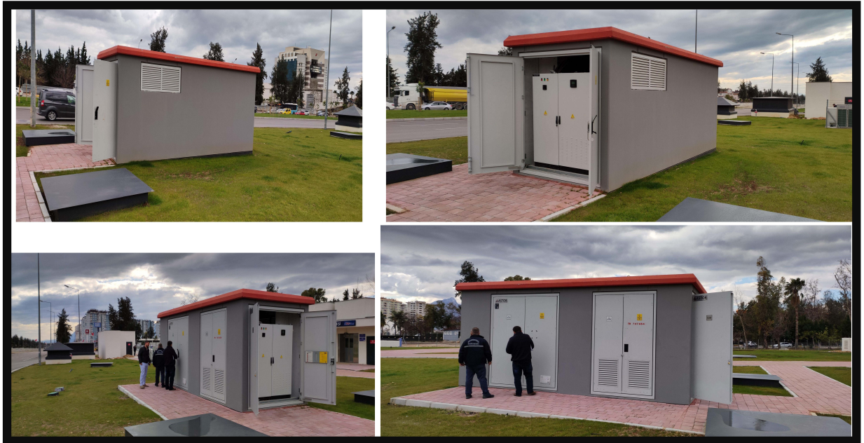
Resim 5. Mevcut Trafo Alanı
